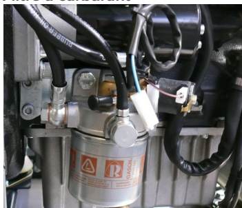
Filtre à carburant
